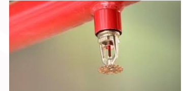
Système d'extinction automatique
